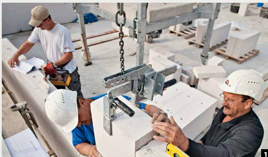
1 Der Maurer verarbeitet die Planelemente nach Angaben der Versetzpläne. Fehlerhaftes Vermauern ist nahezu ausgeschlossen.
