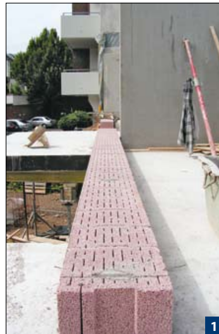
1 Kimmerschicht mit Mörtel MG IIa (LM36) vollkommen flucht- und waagrecht anlegen, erste Plansteine besonders sorgfältig einpassen
