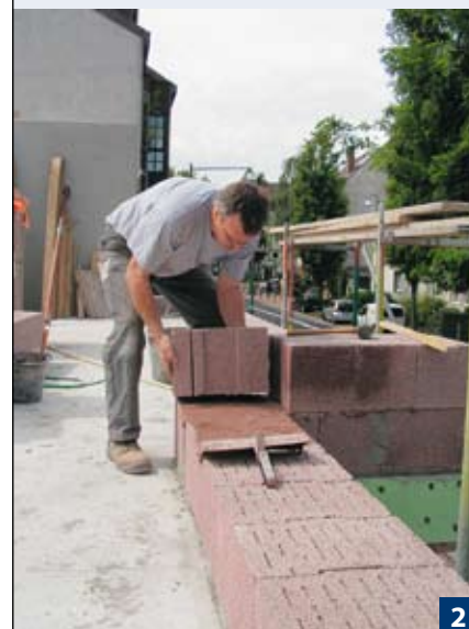
2 Dünnbettmörtel auf die Steinlagen mit einer Zahnkelle oder dem Mörtelschlitten gleichmäßig auftragen. Dabei keine zu große Strecke vorlegen, um die „offene Zeit“ des Mörtels nicht zu überschreiten.“
