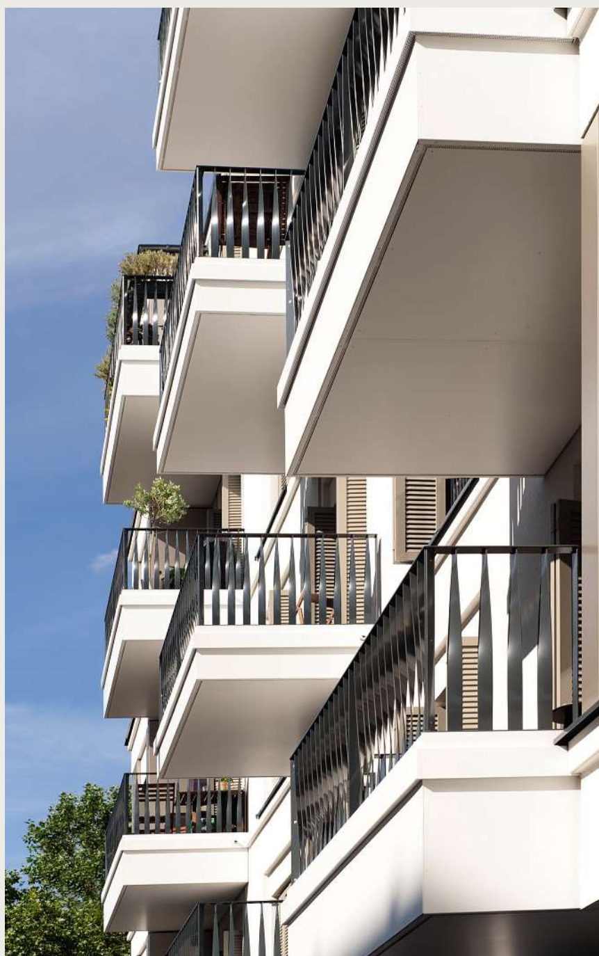
Die Balkone des Pandion Balance wurden mit dem Isokorb Typ RKS thermisch vom Gebäude getrennt.
