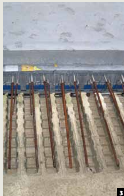
3 Der Fertigteilbalkon mit integriertem Schöck Isokorb® ID wird in die vorgesehenen Öffnungen platziert.
