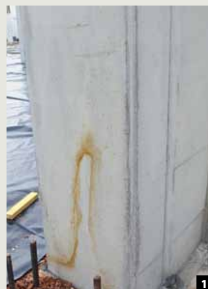
1 Braune, bogenförmige Abfärbungen an Betonoberflächen
