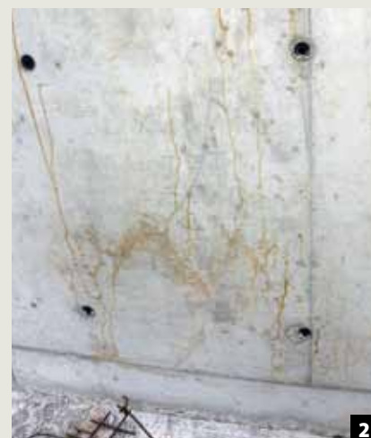
2 Ein weiteres Beispiel für braune, bogenförmige Abfärbungen an Betonoberflächen
