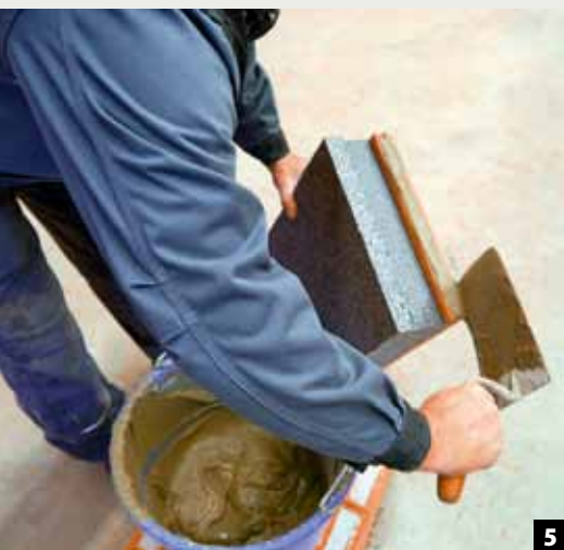
5 Der Dünnbettmörtel wird auf die Stoßfuge aufgetragen und die DRS an die nächste angeschlossen.
